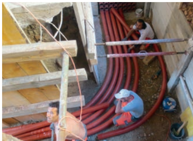
▲ Nach sorgfältiger Prüfung wurde der Kollektor-Gang, bestehend aus einer Vielzahl an Netzkabeln, noch vor eigentlichem Projektbeginn an die Grundstücksgrenze verlegt.
